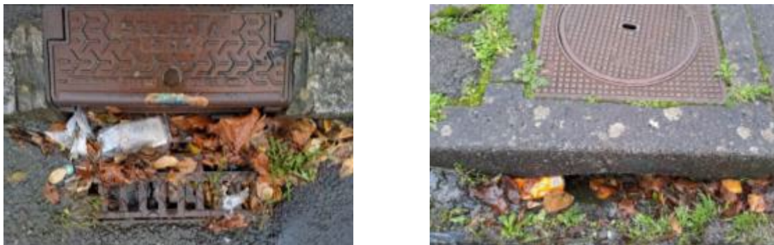
Figure 37 : Avaloir avec grilles (à gauche) et avaloir sans grilles (à droite) (Source : Cedre)
