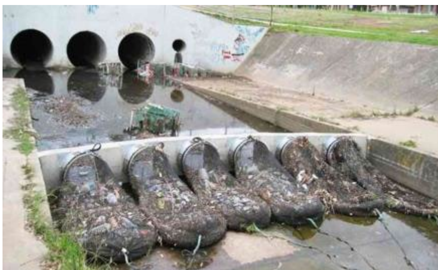
Figure 2 : Filets de rétention posés en sortie d'évacuations dans la ville de Kwinana en Australie (Source ville de Kwinana)
