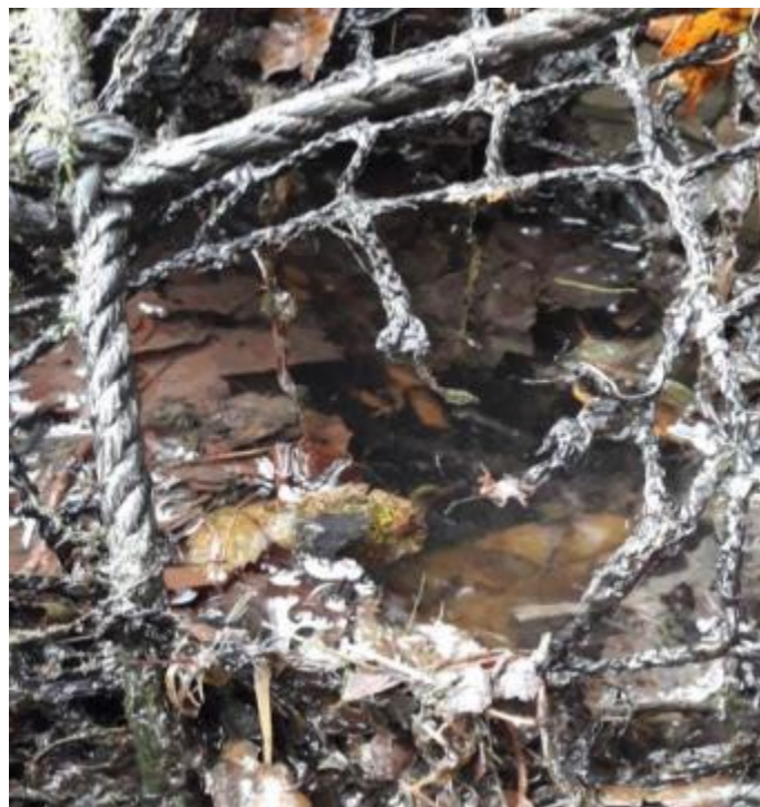
Figure 56 : Trous d'une dizaine de centimètres dans le maillage le plus fin des filets du Stang-Alar (26/11/2022) (Source : Brest métropole)
