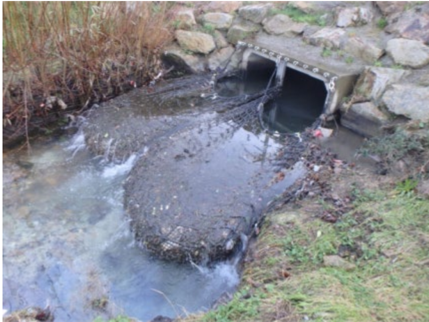
Figure 60 : Décrochage de la partie supérieure du double filet du Spernot (24/12/2020) (Source : Brest métropole)
