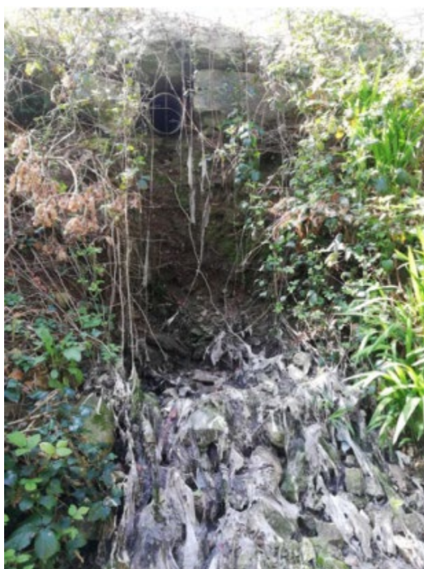
Figure 1 : Point de rejet d'un réseau où de nombreux textiles sanitaires sont visibles (Source Florian Rognard, Cerema)
